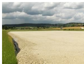
Aire d'installation de chantier préparée en disposant un matelas protecteur en grave
