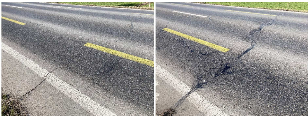
Figure 4 : état de la chaussée (fissuration diverse, orniérage et faïençage)
