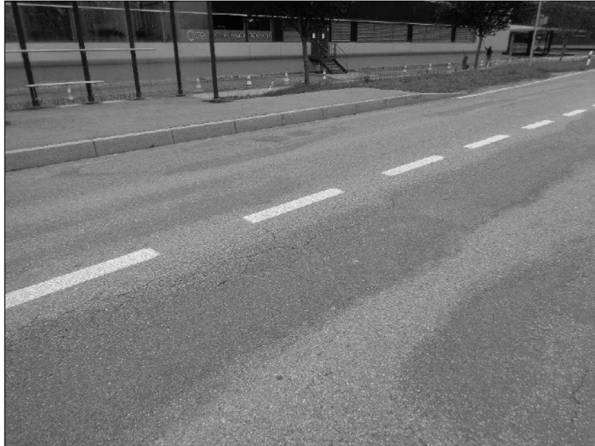
Photo 1 – RC 11 vue direction Crassier, section à deux voies devant l'arrêt de bus « Eysins, Terre-Bonne Nord »
