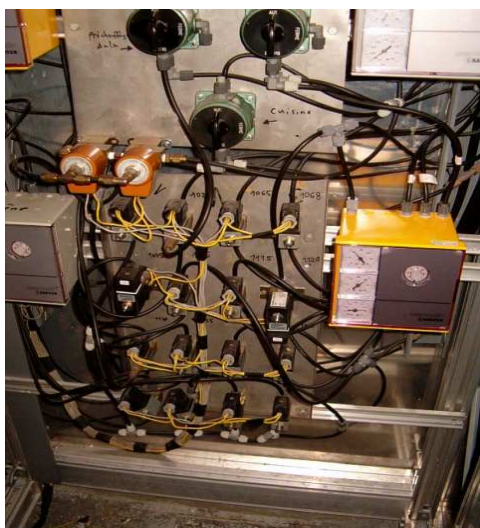
Ancien tableau avec matériel de régulation obsolète et ne disposant plus de pièces de rechange.
