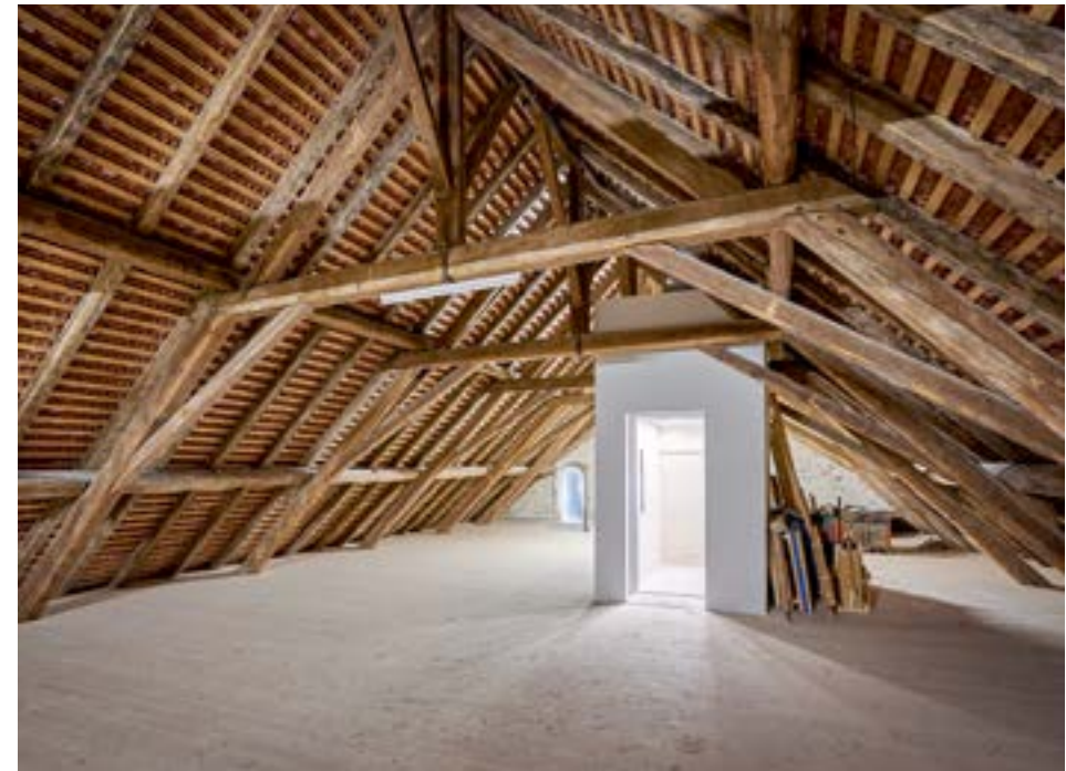
I11.54 Un ascenseur monte-charge sur six niveaux, inséré au cœur du corps de logis sud et qui desservira 80% des espaces visitables.
