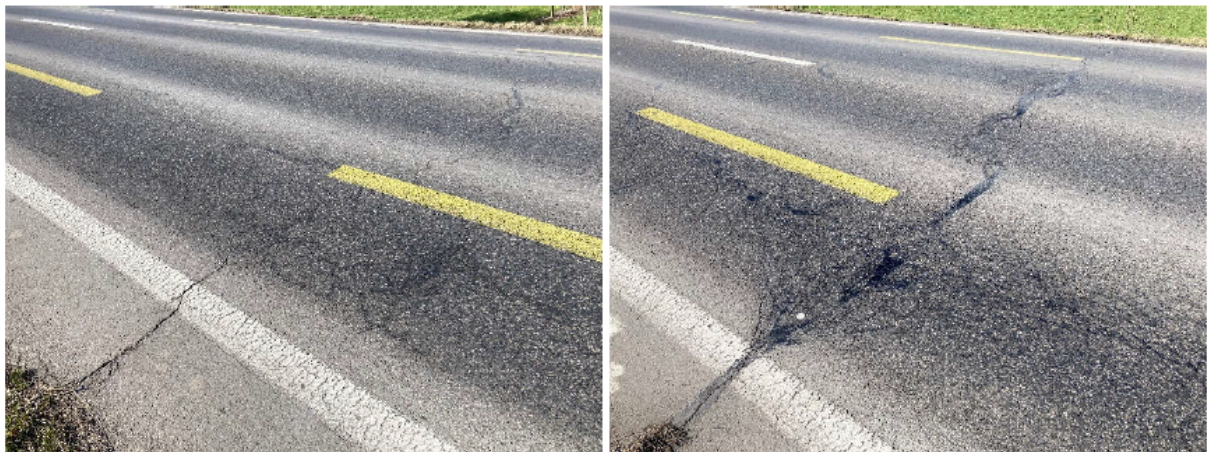
Figure 4 : état de la chaussée (fissuration diverse, orniérage et faïençage)
