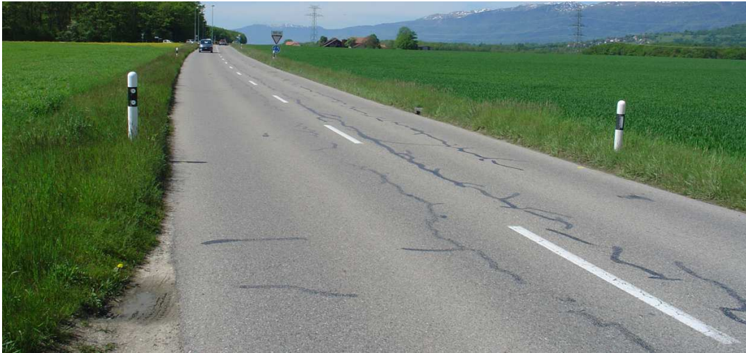
Figure 3 : Fissures dans le revêtement (direction giratoire de la Placette)
