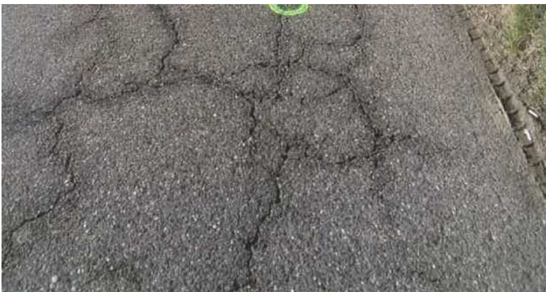
Figure 5 : Fissures dans le revêtement (voie direction giratoire de la Placette)
