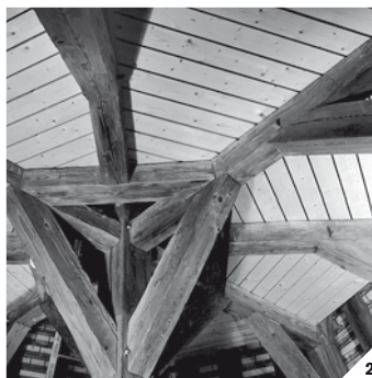
1/ Partie supérieure de la charpente de la flèche; état en cours de travaux © C. BORNAND
