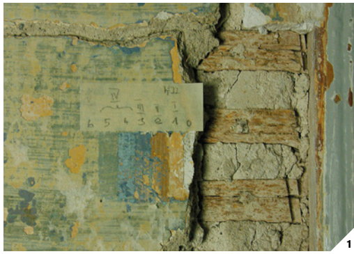
1/ Détail de la stratigraphie sur le mur du couloir montrant une succession de 6 couches superposées sur un enduit de plâtre appliqué sur une cloison en bois et liteaux.
