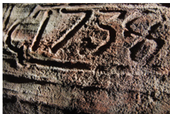
Tuile datée (1758) découverte sur le plan nord de la structure de la toiture de la cure.
